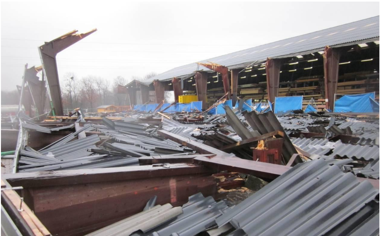
Foto: Na een hevige sneeuwbuï bleek deze constructie niet sterk genoeg om het gewicht van de sneeuw te kunnen dragen.
